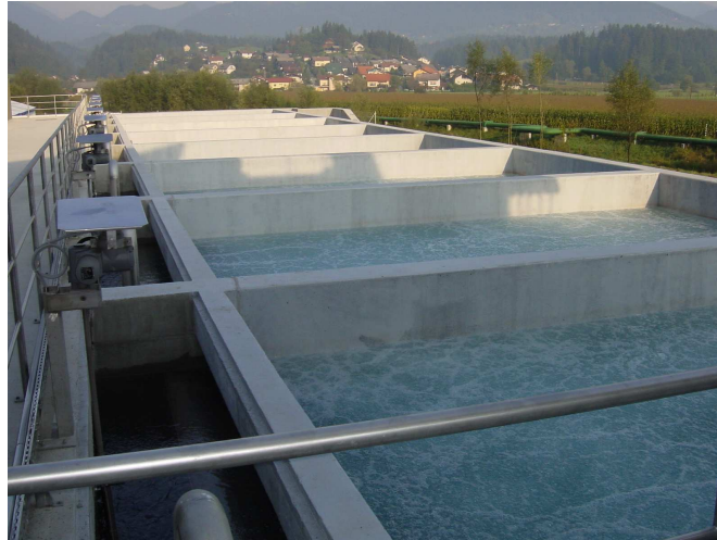
Bild 2: Beispielanlage aufwärts durchströmte biologische Filtration
